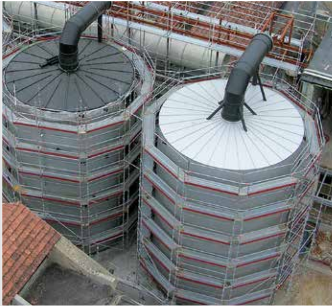
Système de purification de l'air, en Espagne. Matériel: HDPE
